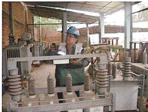
Residuos sólidos peligrosos (transformador eléctrico).
