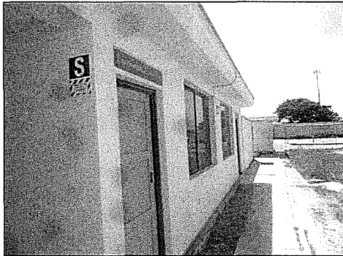
Área administrativa inoperativa
