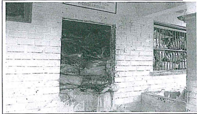
Fotografía N° 13: Vista del segundo Centros de Almacenamiento de Residuos Peligrosos. Obsérvese que dicho centro sobrepasa la capacidad de almacenamiento (Coorcnadas UTM en WGS 84: 9597940N, 0699145E del punto en donde se tomó la foto).
