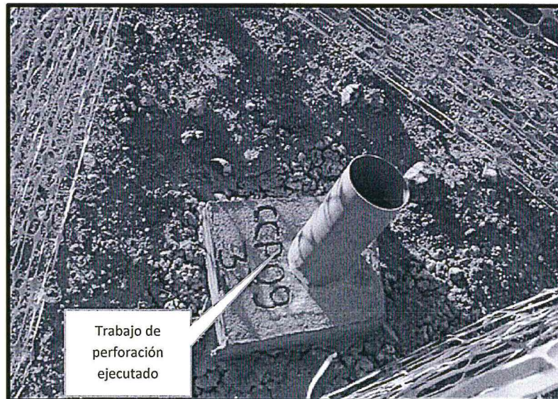
Fotografía N° 26 del Informe de Supervisión.- En el área del proyecto Chucapaca se observa que los trabajos de perforación (taladros) y las plataformas construidas no cuentan con identificación contemplada en el EIAsd.
