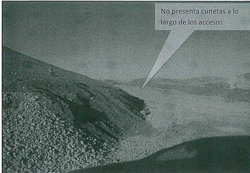
Fotografía N° 28 del Informe de Supervisión.- Se observa que las vías de acceso a las áreas de plataforma de exploración en el área de Katrina no cuentan con cunetas proyectadas para este componente – accesos.
