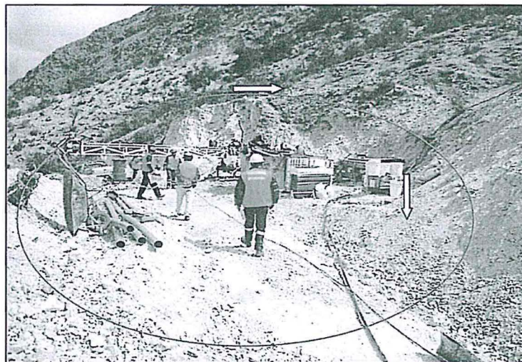
Fotografía N° 10 del Informe de Supervisión: Plataforma de Exploración no programada (719,568 E, 8'413,216 N Datum WGS 84), la máquina de perforación diamantina se encuentra inoperativa en mantenimiento.
