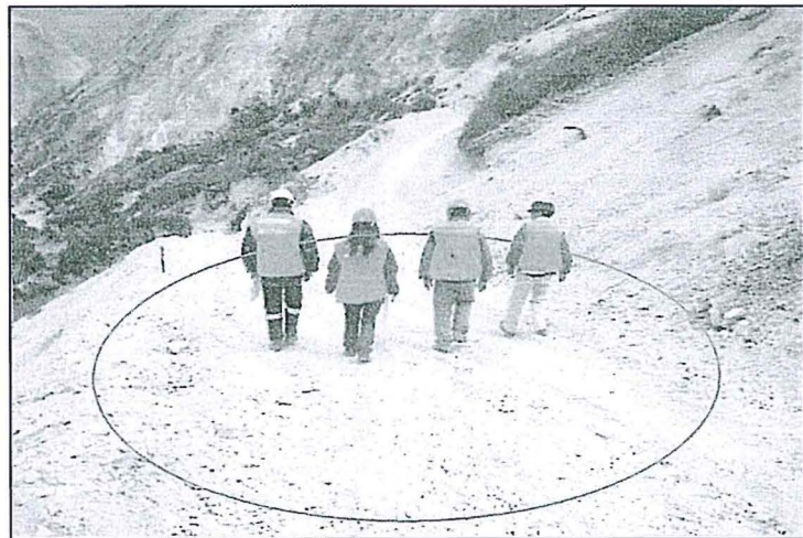
Fotografía N° 40 del Informe de Supervisión: Vías de acceso (trochas) hacia las plataformas de perforación que no cuentan con las correspondientes cunetas de drenaje.
