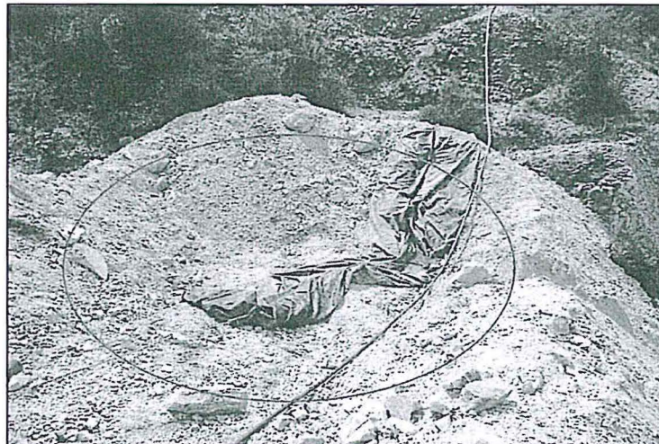
Fotografía N° 9 del Informe de Supervisión: Poza de lodos de la plataforma de exploración no programada, construida sobre relleno hacia la quebrada adyacente.
