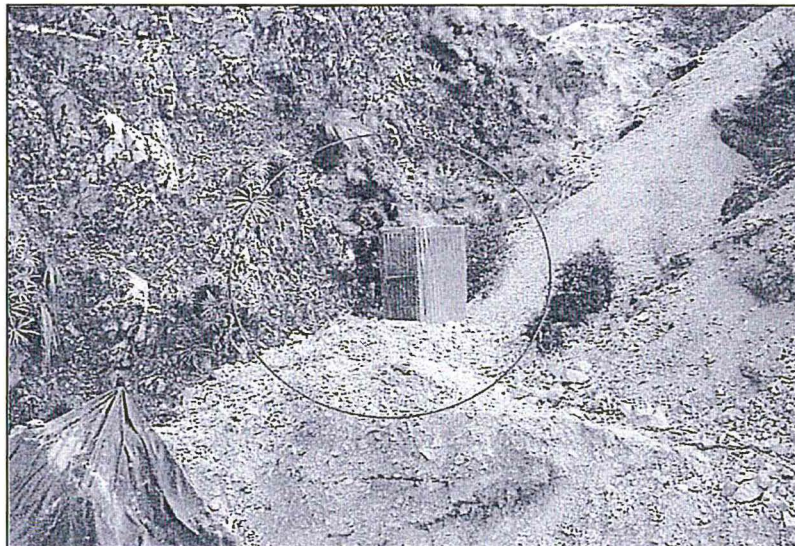
Fotografía N° 15 del Informe de Supervisión: Plataforma de exploración 1W-13, se observa la construcción de una letrina de poca profundidad, no contando con los baños químicos correspondientes.
