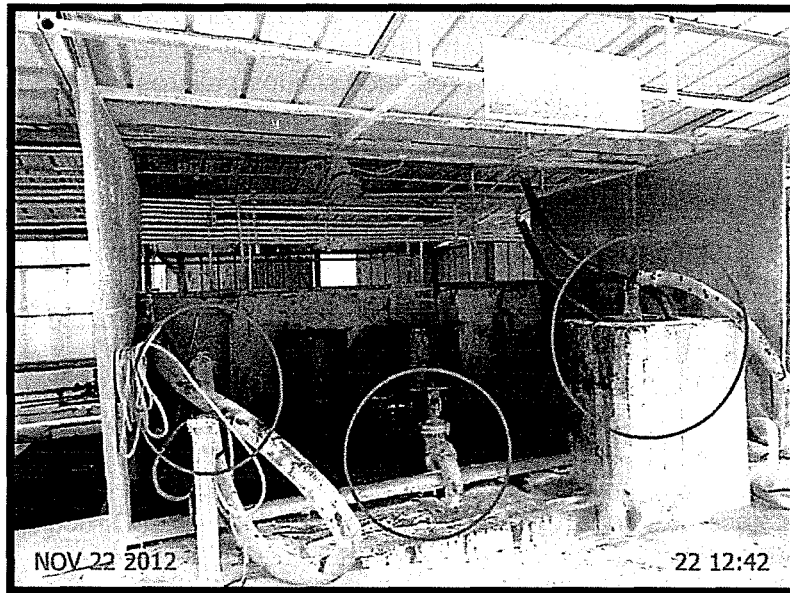
Fotografía N° 40.- Los puntos de recepción de combustibles de aceites usados y diésel N° 2 no cuentan con una señalización para su identificación de sustancias peligrosas.
