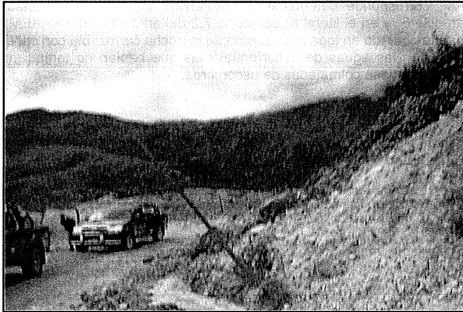
Foto N° 4: Observación N° 2. Trocha carrozable donde se ha producido deslizamiento del talud de corte, producto de las lluvias. La cuneta se encuentra colmatada de escombros y se requiere limpieza, para evitar que los sedimentos se infiltren a los terrenos de la comunidad.
