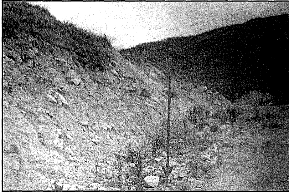
Foto N° 5: Observación N° 2. Otra vista de la cuneta de la trocha carrozable que se encuentra colmatada con escombros y arbustos, por falta de mantenimiento.
