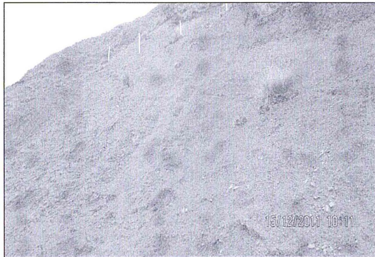
Fotografía N° 29 del Informe de Supervisión: Talud sobre el canal de coronación del depósito de relaves Chinchán no cuentan con monolitos topográficos en la cresta y en el pie de la berma de contingencia para monitorear abultamiento u otros movimientos (coordenadas UTM 8715729N, 364915E, Datum WGS-84)
