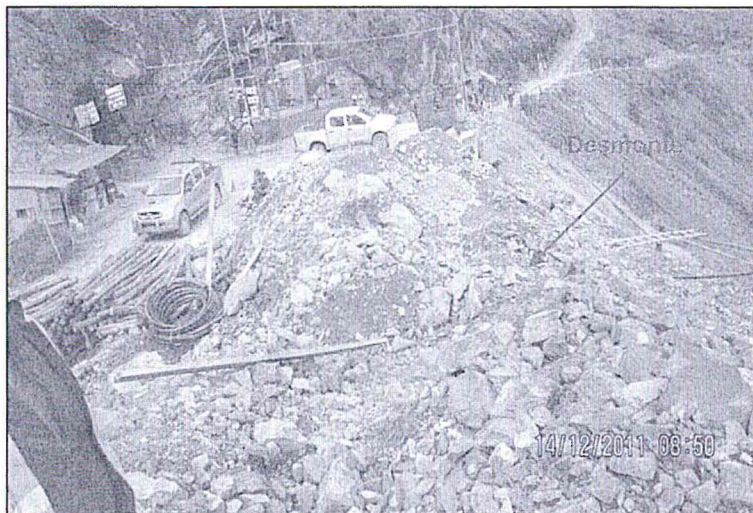
Fotografía N° 17 del Informe de Supervisión: Nivel 821, depósito de desmonte temporal con almacenamiento inadecuado ubicado en las coordenadas UTM: 8 695 537N, 358 370E, Datum WGS-84.
