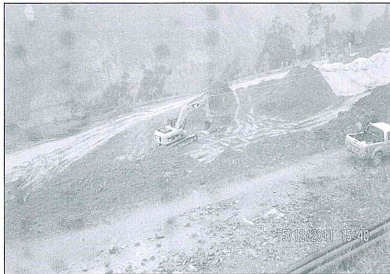
Fotografía N° 30 del Informe de Supervisión: Relave de los depósitos N° 1 y 2, transportados hacia el depósito de Chinchán, sin cumplir lo que indica su estudio ambiental.
