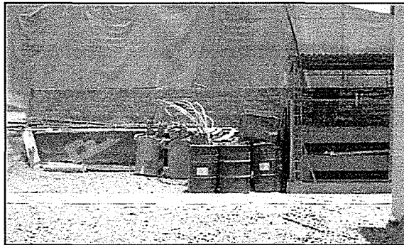
Cilindros y celdas eléctricas en desuso - Patio de llaves
