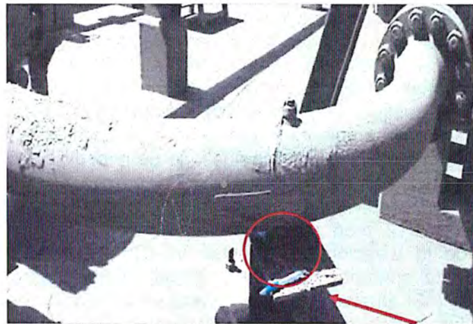
Fotografía N° 36: Rotura del codo de 8 pulgadas.
