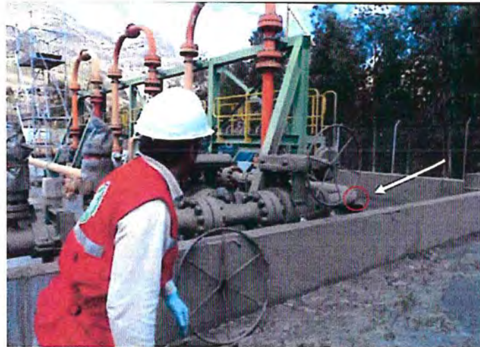
Fotografía N° 11: Codo de 8 pulgadas, en el que se presencia rotura.
