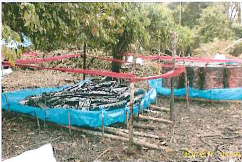
FOTO N° 12: N 9474563, E 468001/ Almacén Temporal de Barreras de Contención impregnadas con Petróleo, del Campamento de Trabajos de Remediación, ubicado al costado de la tubería que tuvo la fuga de Petróleo Crudo
