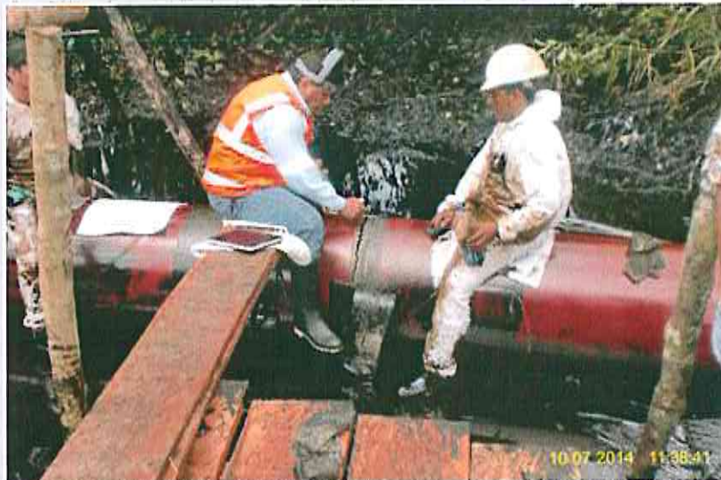
FOTO N° 6: N 9474535, E 467992 / Vista y ubicación del punto en que se tiene la rajadura de la Tubería del oleoducto del Tramo 1.
