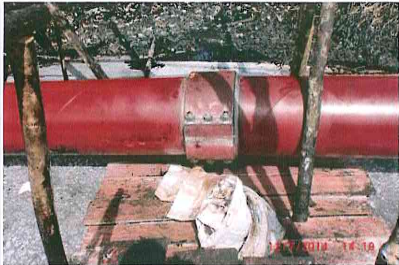
FOTO N° 13: N 9474535, E 467992 / Vista de la Grapa colocada y soldada a la tubería del Oleoducto del Tramo 1, en que se encontraba la rajadura por la que se tuvo fuga de Petróleo Crudo, quedando en su posición final.
